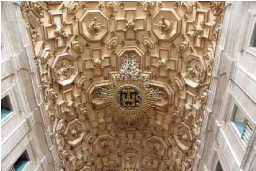
Figura 8 - Forro da Nave da Catedral de Salvador
